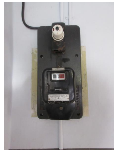
Dazu gehörte auch solch ein Sicherungskasten
