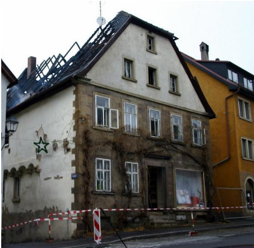
Das Gebäude kurz nach dem Brand
