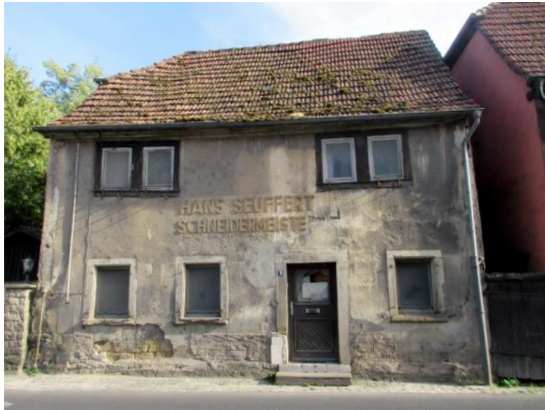
Zwar ist das Foto noch nicht so alt, doch schon damals drüfte das Gebäude Schweinfurter Str. 8 kaum besser ausgesehen haben
